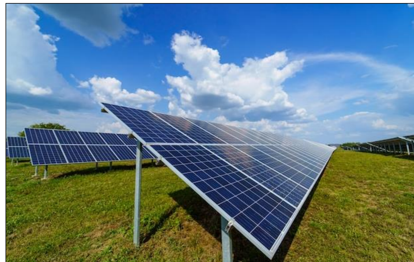
Fotografie 3: Detail konstrukce fotovoltaické elektrárny a údržbového pásu (Zdroj: Shutterstock)
