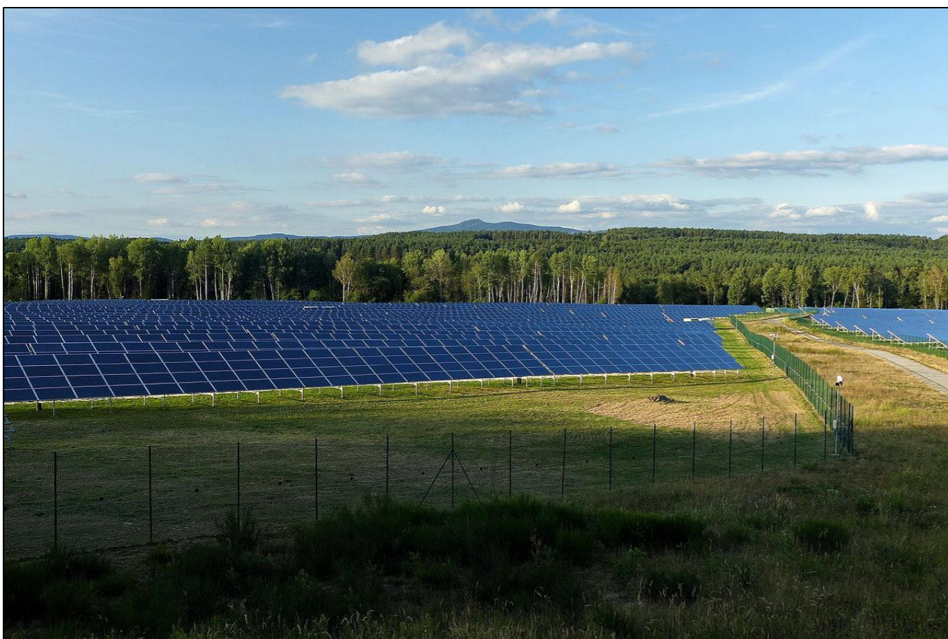
Fotografie 2: Fotovoltaická elektrárna Ralsko Jabloneček (Autor: Ladislav Soukup)
